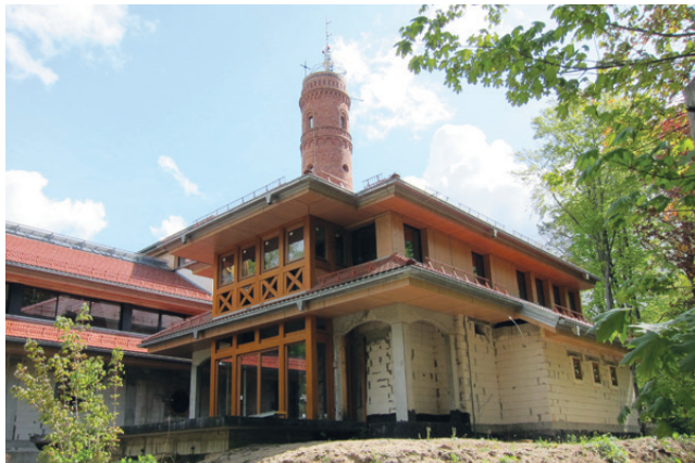
Die Baustelle für das Pilger- und Touristenzentrum rund um den Gollenturm ist immer noch Baustelle!
